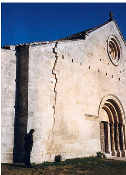
Basculement de la façade ouest et reconstruction de l'angle à la verticale, XII e siècle, église du Prieuré, Salagon, France.
