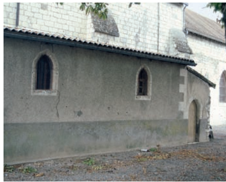
Chute de claveau et fissure, Vendevre-en-Poitou, France.
