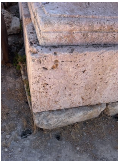
Rotation des blocs d'angle du podium par rapport à leur fondation, Temple d'Hercule, angle nord-ouest, II e siècle ap. J.-C., Aman, Jordanie.
